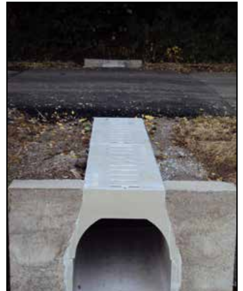
Entrée et sortie des crapauducs à chaque extrémité de la route
