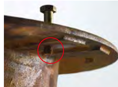
På grund af bolten, der går gennem flangen, er en sikker og permanent tætning ikke mulig
