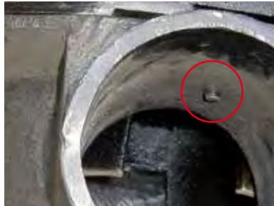
Afløb med bolt i rørledningen hindrer fuldstændig tætning
